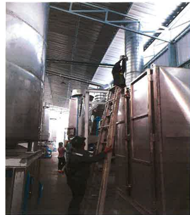
ปล่องระบายอากาศของระบบฟันทึ/แวก์คัม ซึ่งช่วยลดการปล่อยไอสารเคมี Xylene และ Toluene
