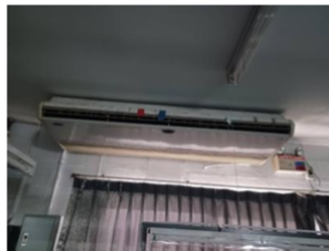
(เครื่องปรับอากาศเดิมใช้ R22)
